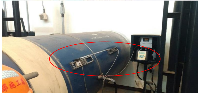
林口火力電廠 (海水泵, 1.2M pipe)
