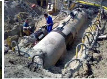
地下水泥管道
