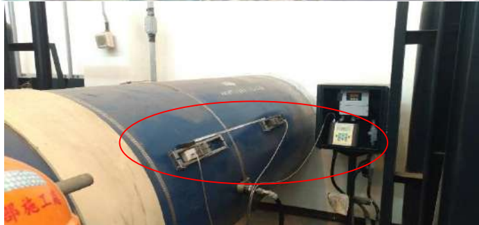
林口火力電廠 (海水泵, 1.2M pipe)
