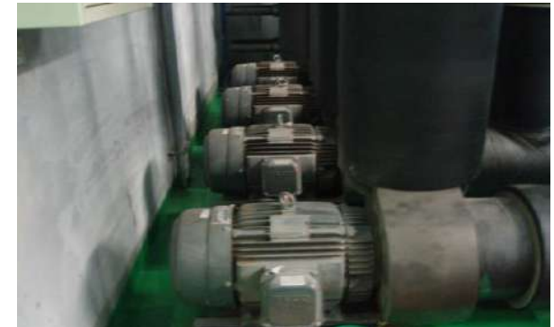
水泵未導入變頻控制
