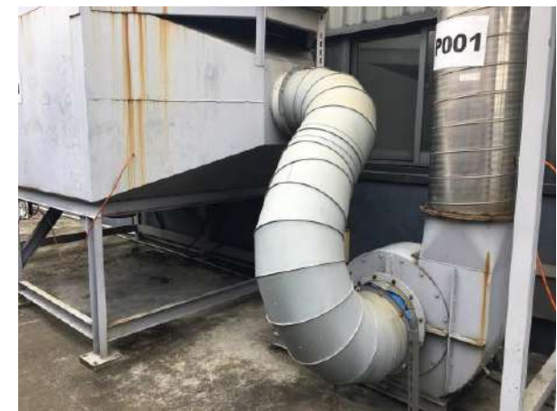
風管急彎壓損大
