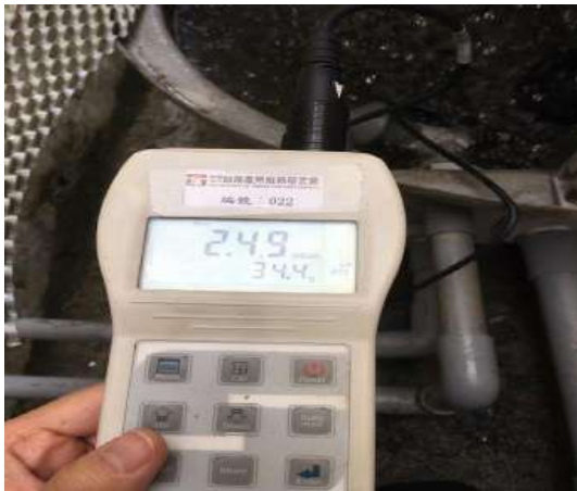
冷卻水塔未進行水質管理
